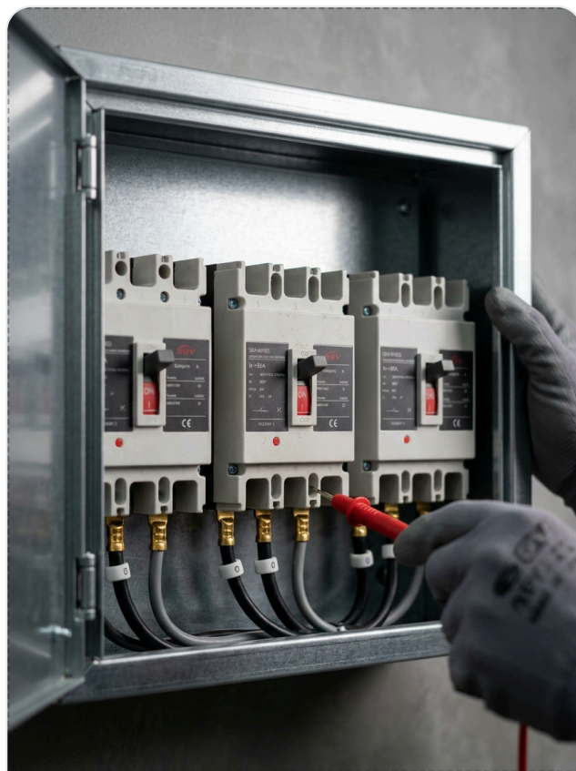
Quadro de distribuição em operação · linha SGV1
